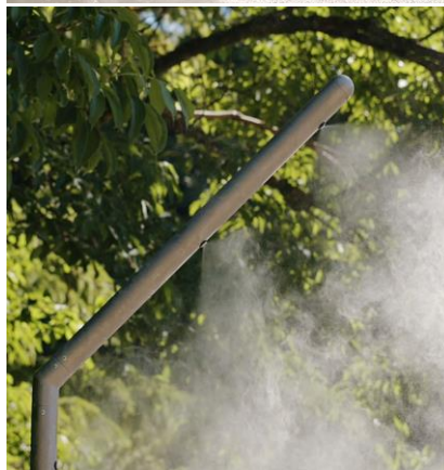
Installation de brumisateurs dans les parcs urbains de la Ville de Dijon (21) Crédit photo : aj3m
